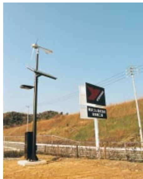
新城南工場のハイブリッド蛍光灯
