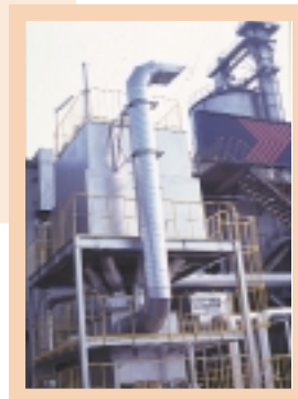
三重工場に設置された大型脱臭装置
