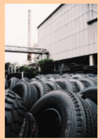
他工場の試験タイヤも焼却する 三重工場の廃タイヤ焼却ボイラー
